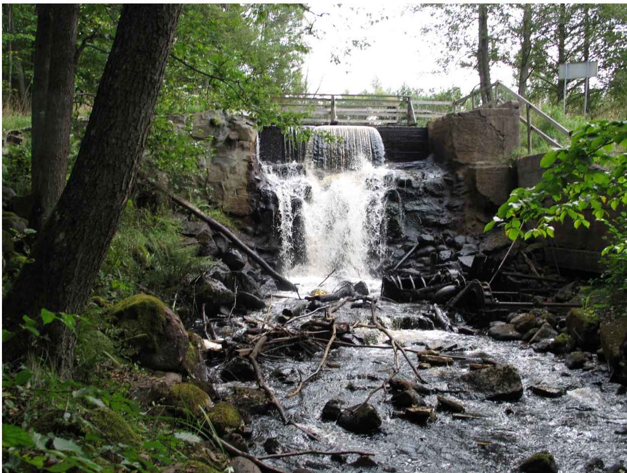
Hultadammen med en havererad kraftverksturbin. Foto: Örjan Nilsson, Länsstyrelsen
